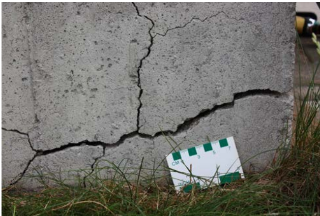
Figure 4 : Fissuration d'une structure de béton par réaction de pyrrhotite.
